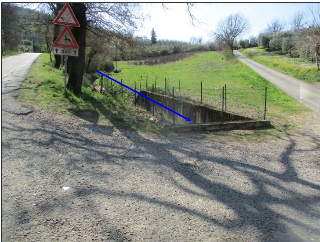
Foto 7. E-Le Vaglie – Tratto di monte – Vasca di sedimentazione e trattenimento materiale flottante.
