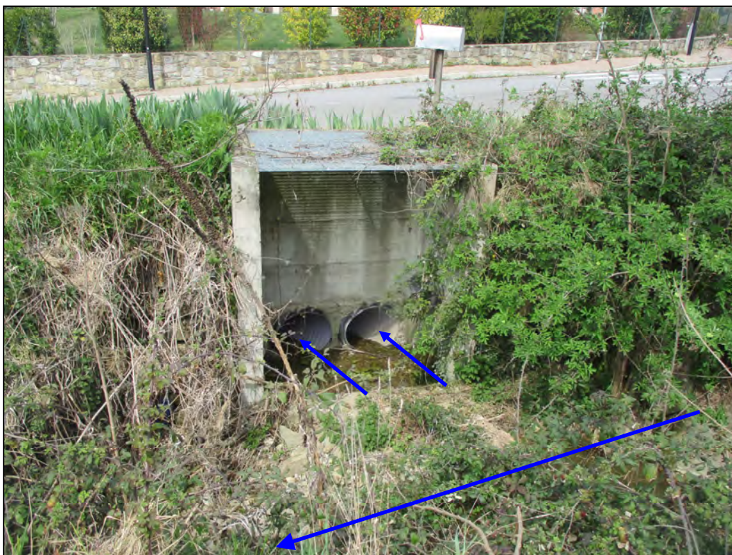
Foto 16. H-La Vigna – Pozzetto scolmatore.
