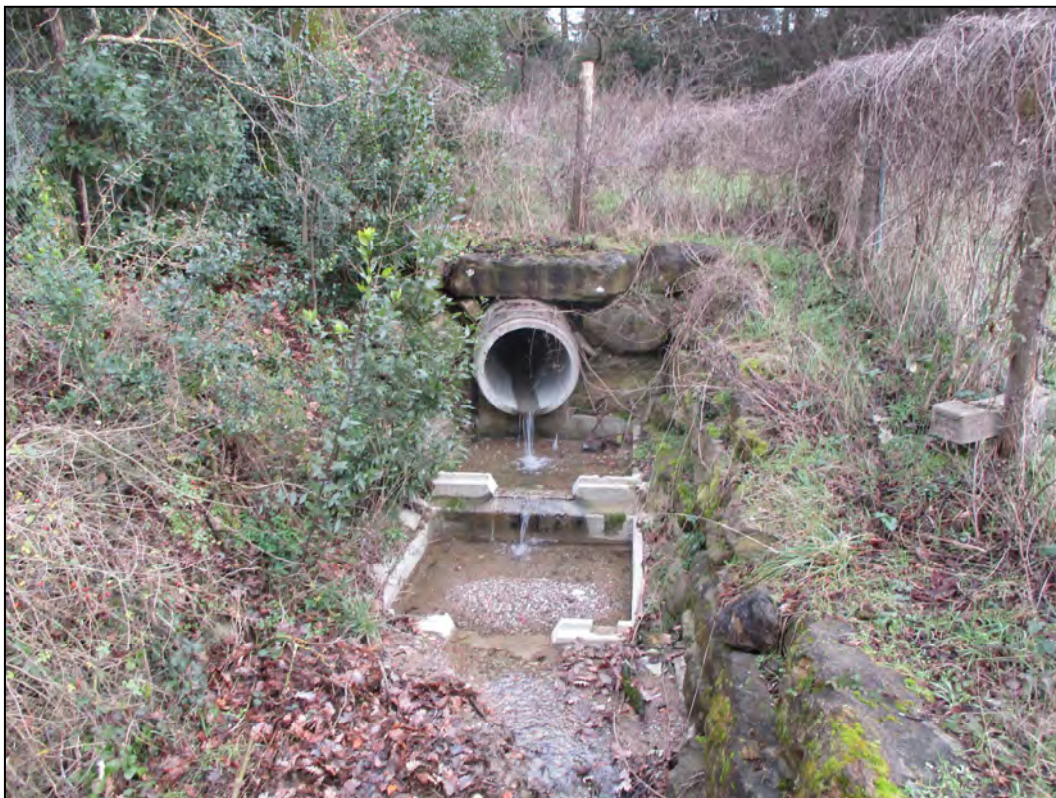
Foto 21. L-Castello – Tratto di monte - sistema di sedimentazione.
